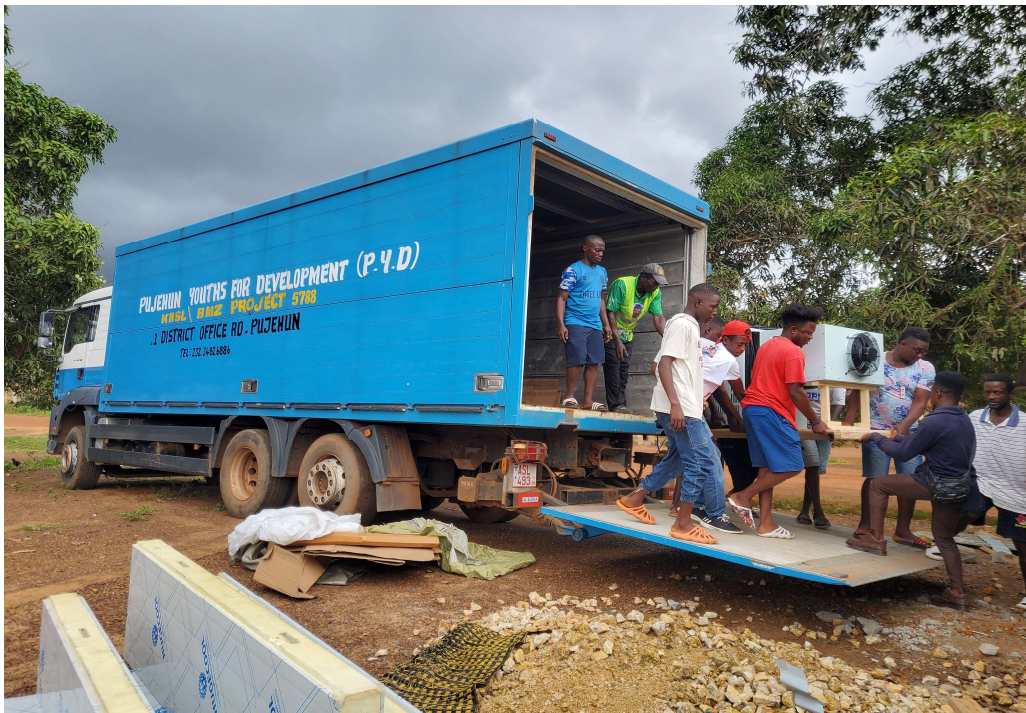
Die begehbaren Kühlräume wurden als Komplettpakete an die jeweiligen Gemeinden geliefert und dort installiert. Hier wird gerade ein Kühlaggregat mit dem Projekt-LKW im Dorf Najay angeliefert. Vorne links sieht man zwei Sandwich-Isolierpaneele mit Polyurethan-(PU)-Füllung.
